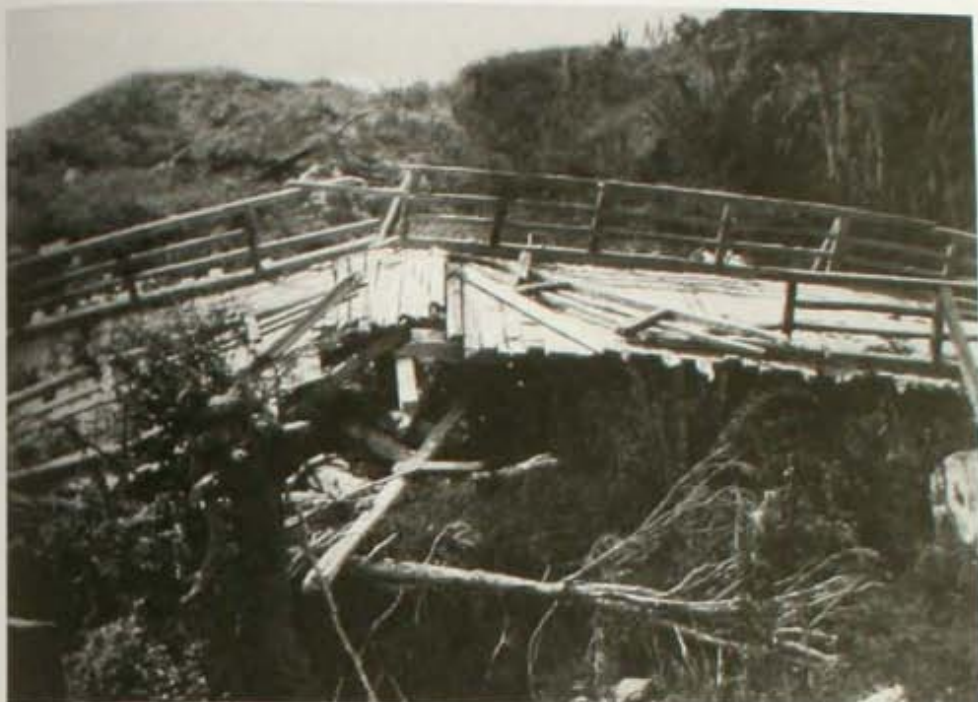
Estado en que se encontraban en 1911 los puentes construidos por la Compañía del Baker a raíz de las crecidas de los ríos del distrito homónimo.
